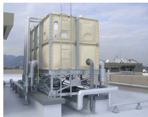
写真-7 高置水槽（FRP製）の配管支持例
